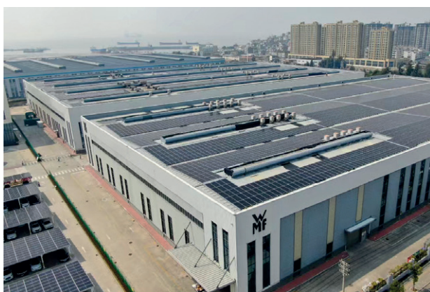
Panneaux solaires à Yuhuan, Chine
